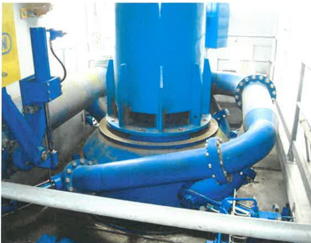
Il gruppo di produzione turbina + generatore
