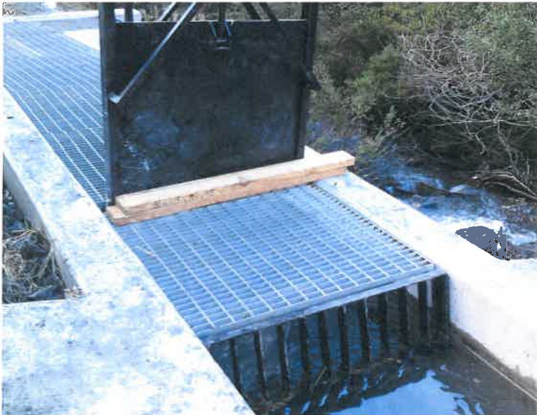
Vista da monte dell'imbocco della presa del Ru du Moulin con relativa paratoia
