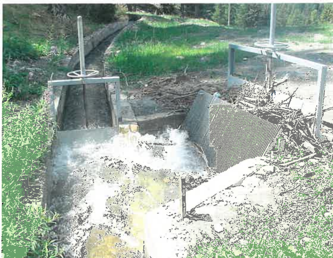
La presa dell'impianto idroelettrico in esame lungo il Ru du Moulin. La vasca di carico è completamente interrata a destra della griglia e dell'annessa paratoia
