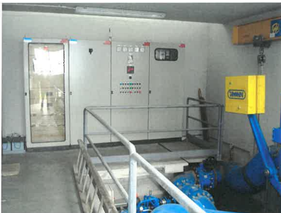
Quadri all'interno della centrale
