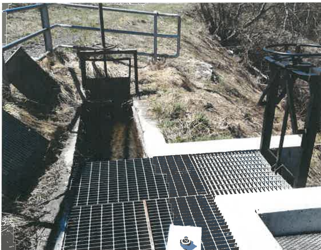
Vista da monte della presa del Ru. Sulla destra la paratoia dissabbiatrice, sullo sfondo quella posta all'inizio del tratto "intubato" del Ru
