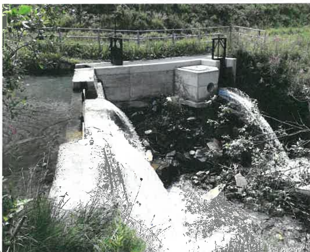
Vista complessiva, dalla sponda destra orografica, dei manufatti dell'opera di presa del Ru du Moulin. Il pozzetto con il foro circolare è stato predisposto per l'eventuale installazione di una valvola di scarico
