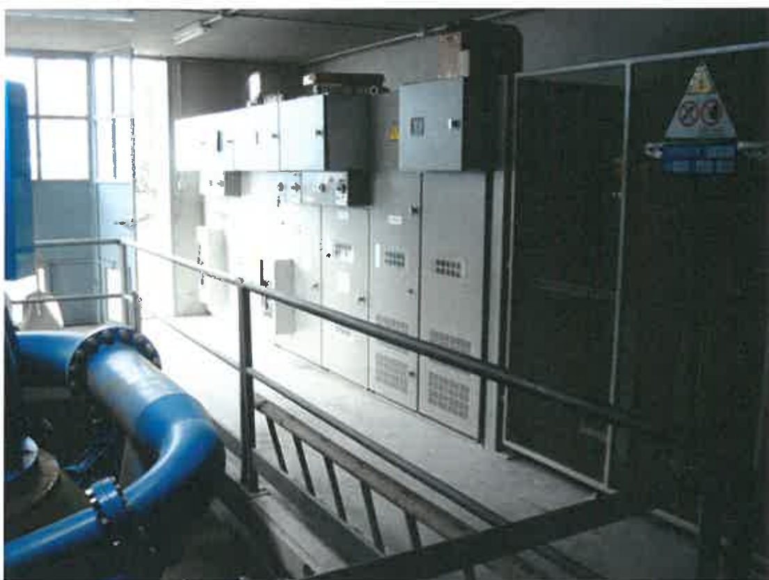
Trasformatore e quadri all'interno della centrale
