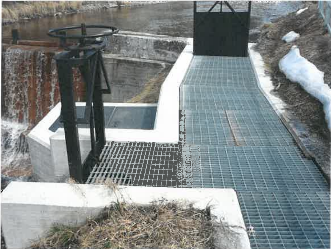
Vista ravvicinata, da valle, della paratoia dissabbiatrice (a sinistra) e di quella posta sull'imbocco della presa
