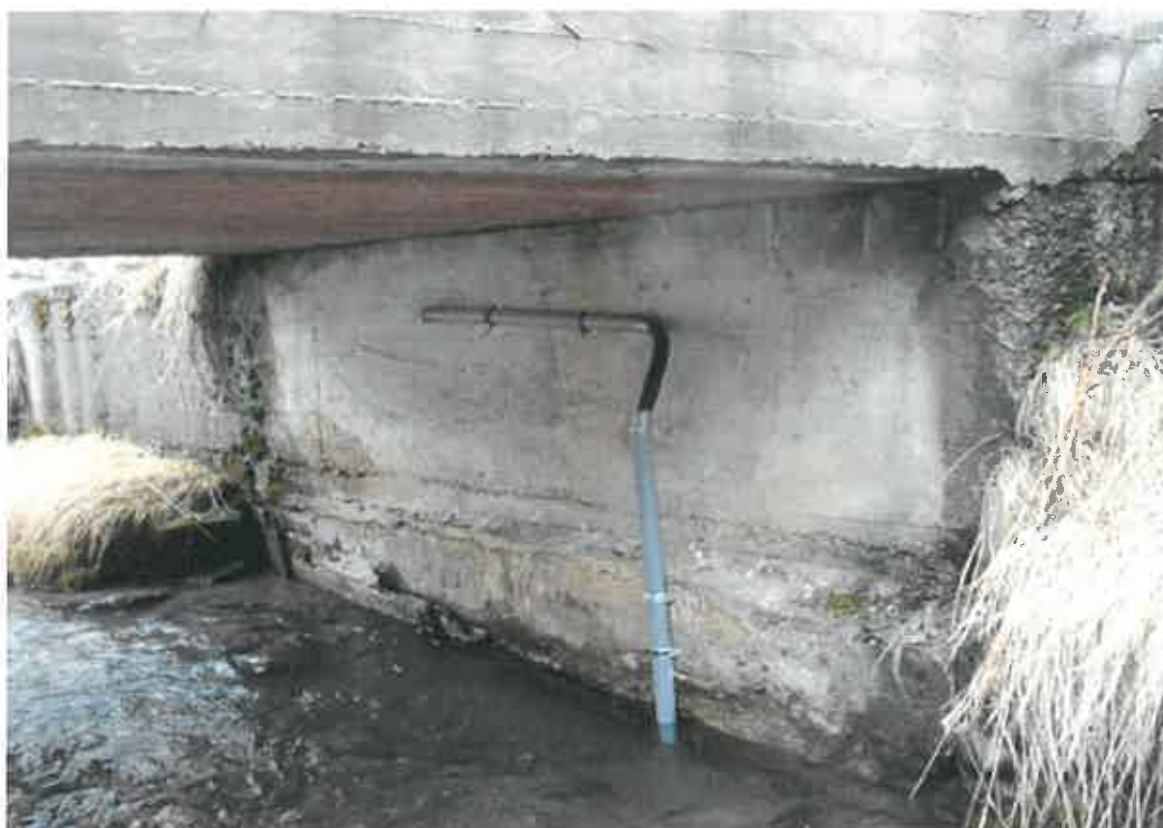
La strumentazione attualmente presente contro la spalla sinistra del ponte che permette di ricavare le portate fluenti mediante la misurazione del livello dell'acqua
